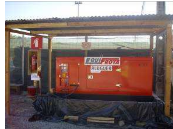
(18) Modelo do Plano de Gestão Ambiental Tipo e exemplo da aplicação das metodologias de controlo e contenção de derrames em obra
